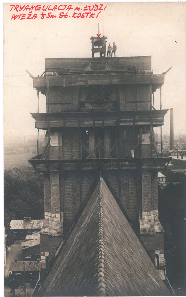
Stanowisko teodolitu na będącej w budowie wieży kościoła św. Stanisława Kostki, podczas pomiaru kątów sieci triangulacyjnej w 1919 r.
